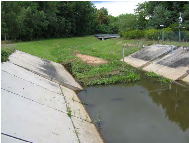
Sedimentablagerungen Zuleiter SB Lohsa II
