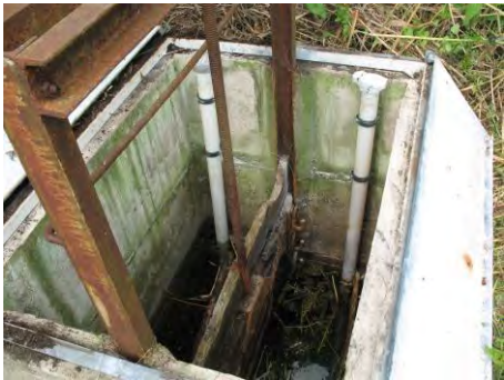
Ent- und Bewässerungsanlagen in Feuchtgebieten
