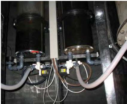
Ausgleichsbehälter zur Steuerung der Grundwasserstände und Messung der Zu- oder Abflüsse
